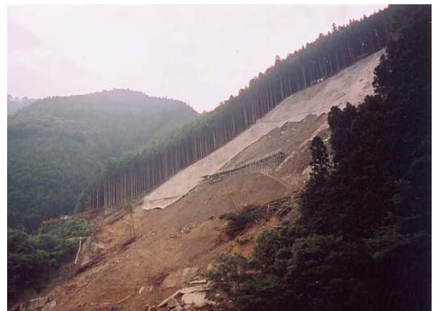
地すべり状況(上部は吹付け法枠施工)
