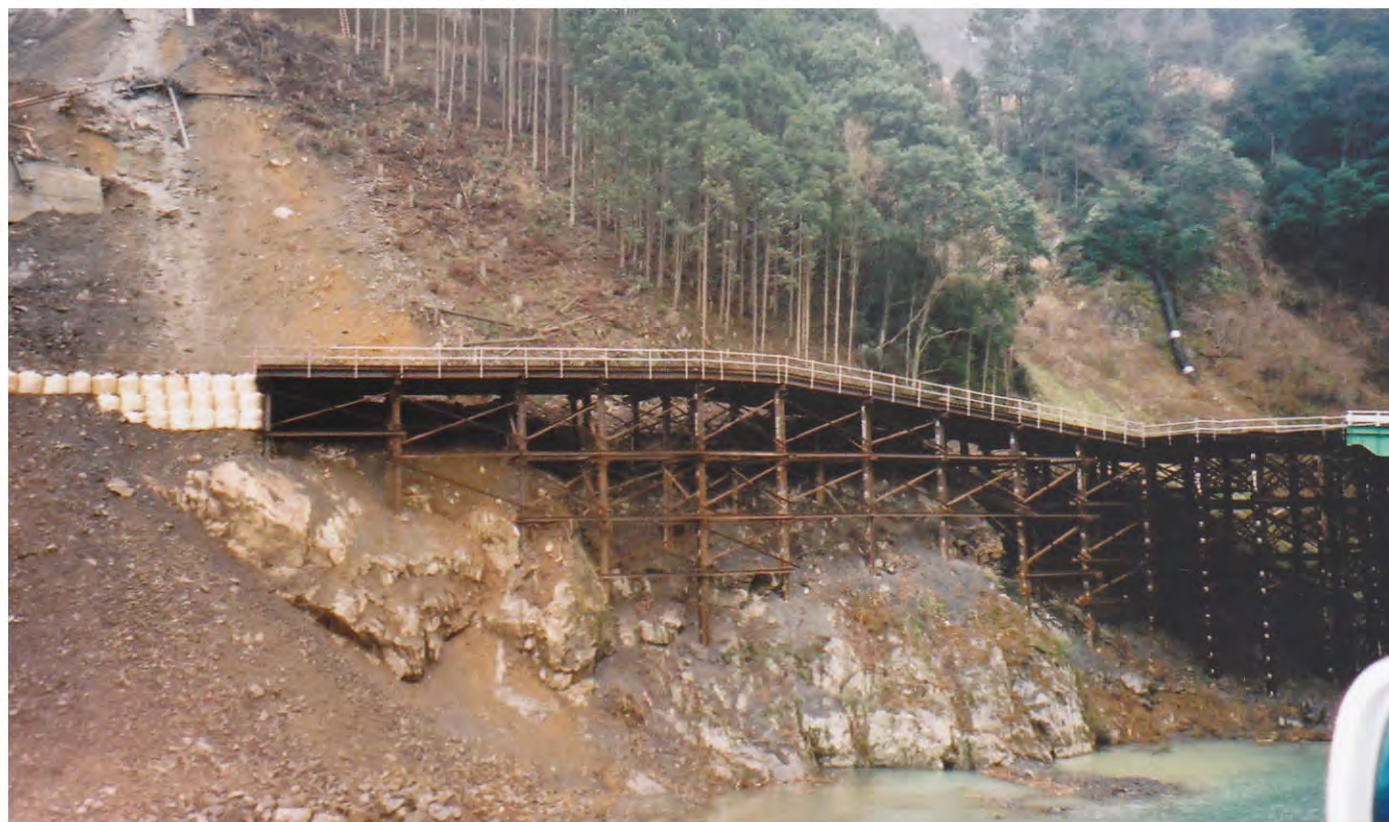
大雨による地すべりで道路崩壊(仮橋施工)
